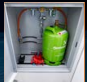
MOBILE VERSORgUNG Betrieb autark oder elektrisch
