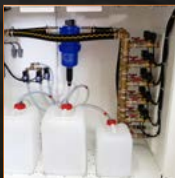
Automatische Dosierung Desinfektionsmischung
