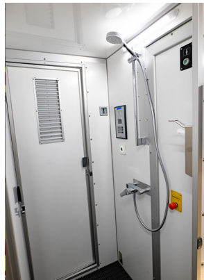
Dusche mit 2-stufiger Abwasserfiltrierung
