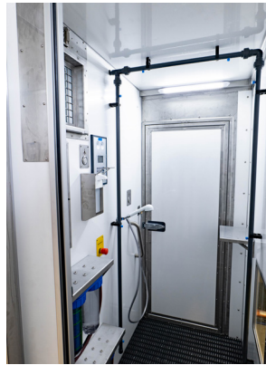
Desinfektionsbereich im Unterdruck mit Dusche und Sprühdesinfektion
