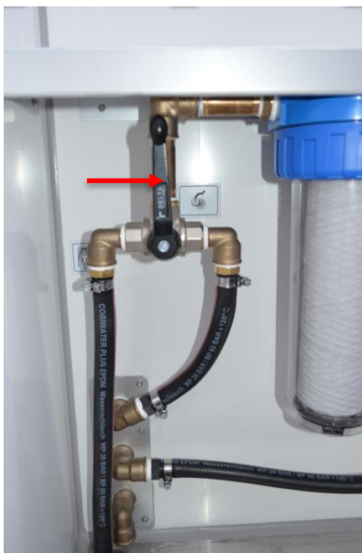
Abb. 23 Posición de la válvula de bola para el filtrado de aguas residuales
