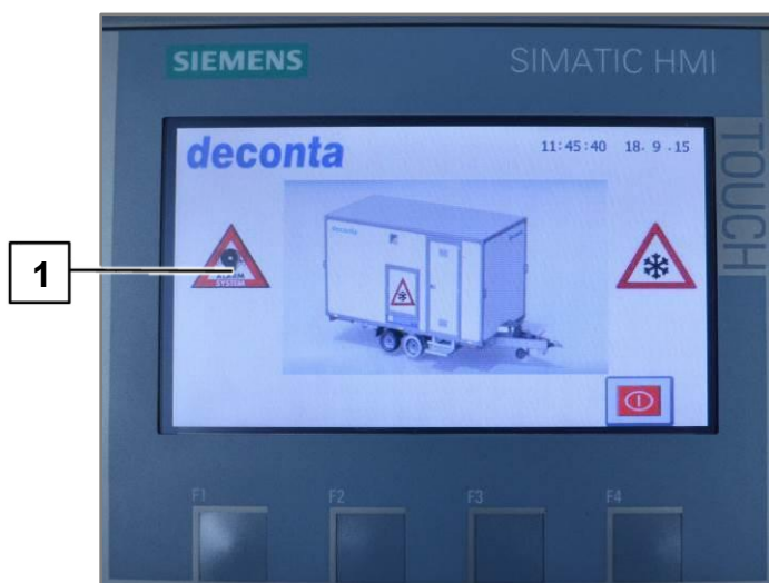
Abb. 78 Estado del sistema de alarma
