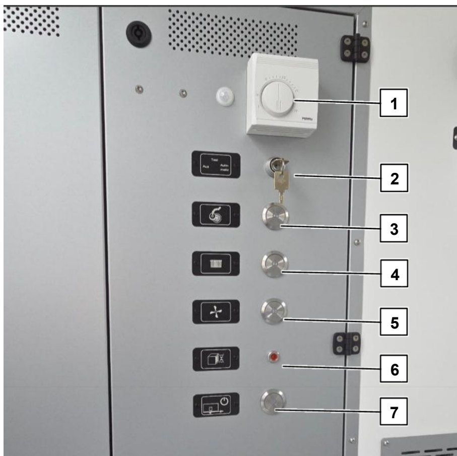
Abb. 20 Panel de control y termostato para la calefacción de la vivienda en la gama de colores blancos
