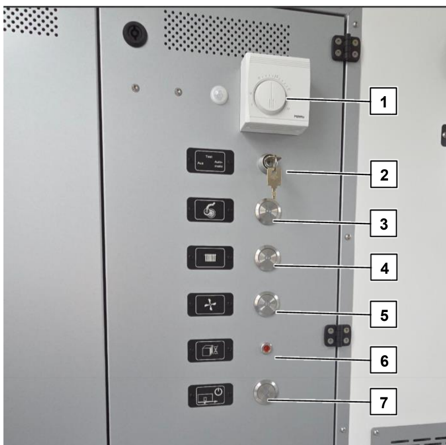
Abb. 20 Pannello di comando e termostato per il riscaldamento degli ambienti
