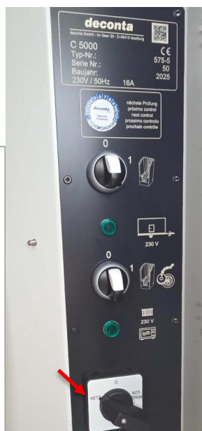
Abb. 3 Armoire électrique avec commutateur « Réseau / Alimentation de secours »
