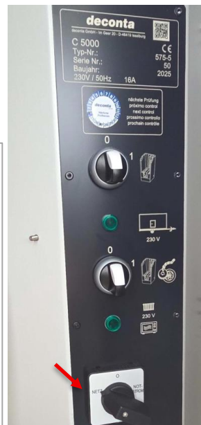
Abb. 3 Schaltschrank mit Wechselschalter „Netz / Notstrom“
