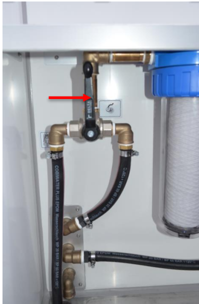
Abb. 23 Kugelhahnstellung zur Abwasserfilterung
