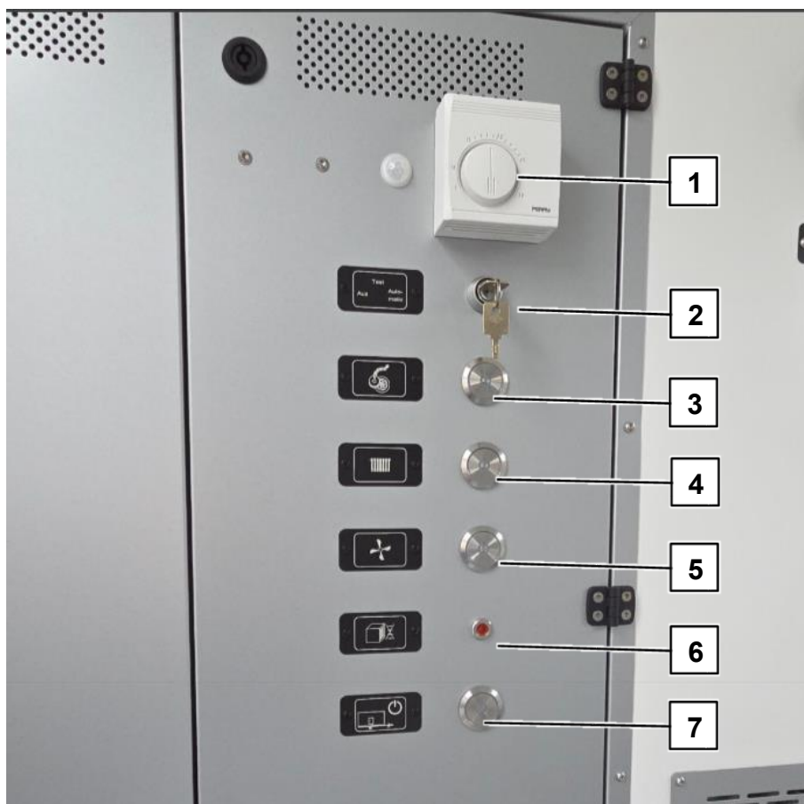
Abb. 20 Bedienpanel und Thermostat zur Raumheizung im Weißbereich
